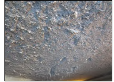
Photo N° 663 ECH-N°1 FLOCAGE -- LOCAL POUBELLE Plafonds blanc cotonneux
